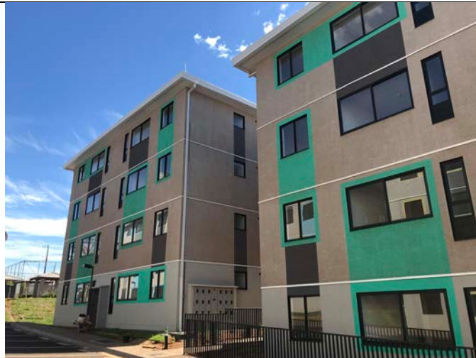
Figura 10 – Imagem das pingadeiras (ressaltos) instaladas.
