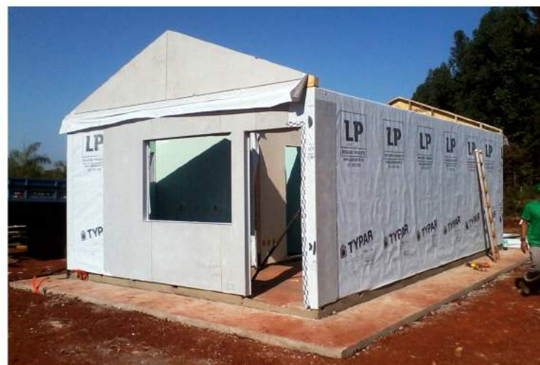
Figura 23 - Painéis montados no canteiro de obras com membrana hidrófuga exposta e parte com chapeamento em cimentícia Fonte: Tecverde Engenharia S/A
