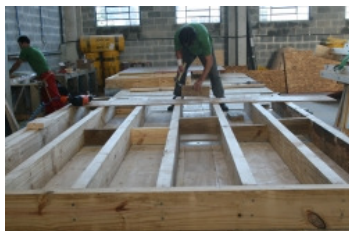
Tecverde: montagem do painel da cobertura da casa (foto: Franklin de Freitas)
